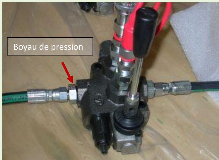
Figure 42 : Connexion du boyau de pression sur la Vanne monobloc.
